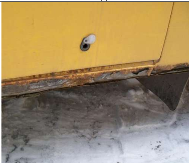
ПАЗ-423470, Коррозия на порогах и крыльях
