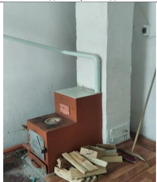
Здание ФАП в Бобково, Котёл отопления
