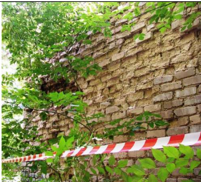
Клуб в Потеряевке, Аварийная северная стена
