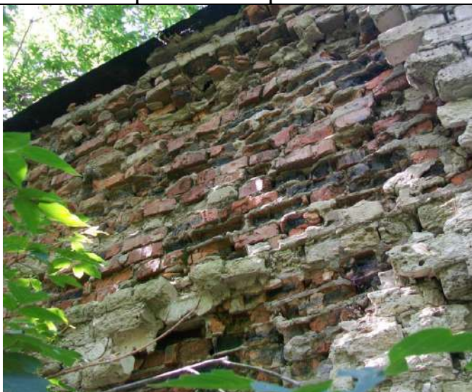
Клуб в Потеряевке, Аварийная восточная стена
