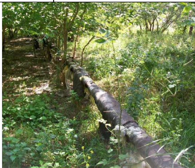
Клуб в Потеряевке, Надземная теплотрасса
